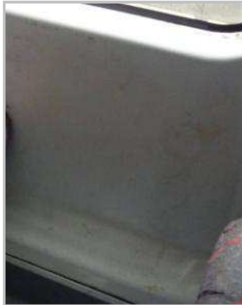
Conforme en exploitation
