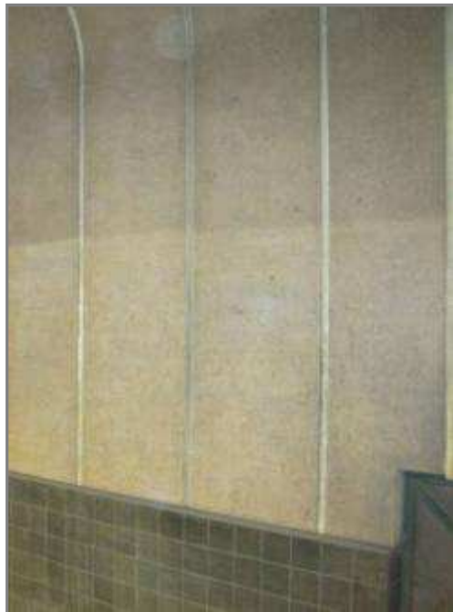
Conforme en exploitation
