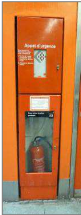
Conforme en exploitation
